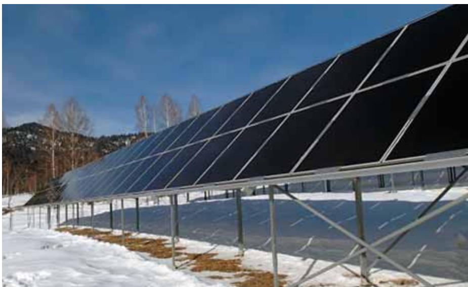
Гибридная энергоустановка в селе Яйлю, Республика Алтай.
