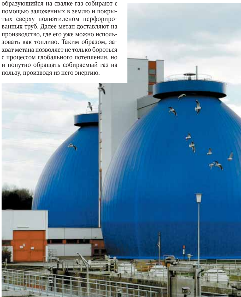
Газоуловители для сбора метана. Очистные сооружения города Эшах, район Равенсбург, Германия. Фото: Factory X/wikipedia.org
