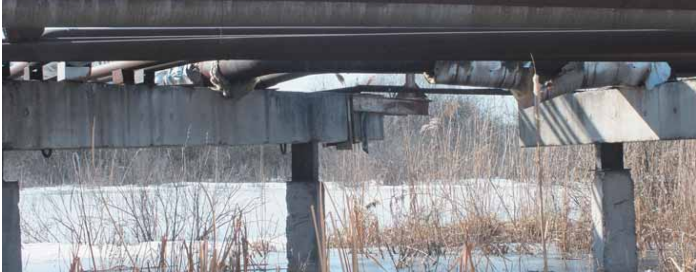
Один из многих ржавых трубопроводов, расположенных на прилегающей территории аварийного предприятия. Фото: Владислав Филипов
