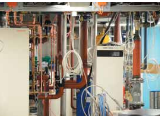
Здание музея «Халтия» обогревается и охлаждается за счет энергии земли и солнца. В скале под центром пробурено 15 скважин, которые достигают около 300 м в глубину. Отопление и охлаждение основано на проходящем в скважинах геотермальном трубопроводе длиной в 11 км.
