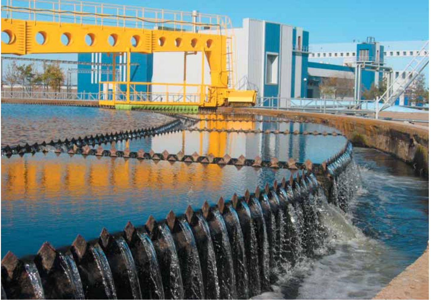
Первичный отстойник на Северной станции аэрации в Петербурге.
