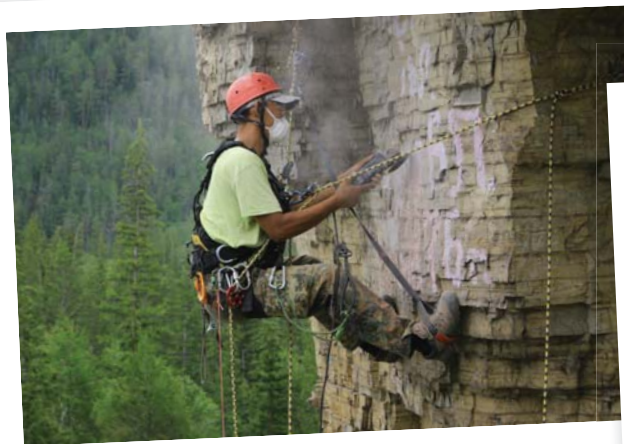
Инструмент используется разный, от зубил и долото до пескоструйного аппарата и болгарок с шлифовальными насадками. По словам участников проекта, в России опыта очистки скал пока еще нет, поэтому сначала были опробованы разные способы (механический и химический) и выбран наиболее эффективный. Очистка происходит очень бережно, никакого вреда скалам не наносится. Фото из архива природного парка «Ленские Столбы»
