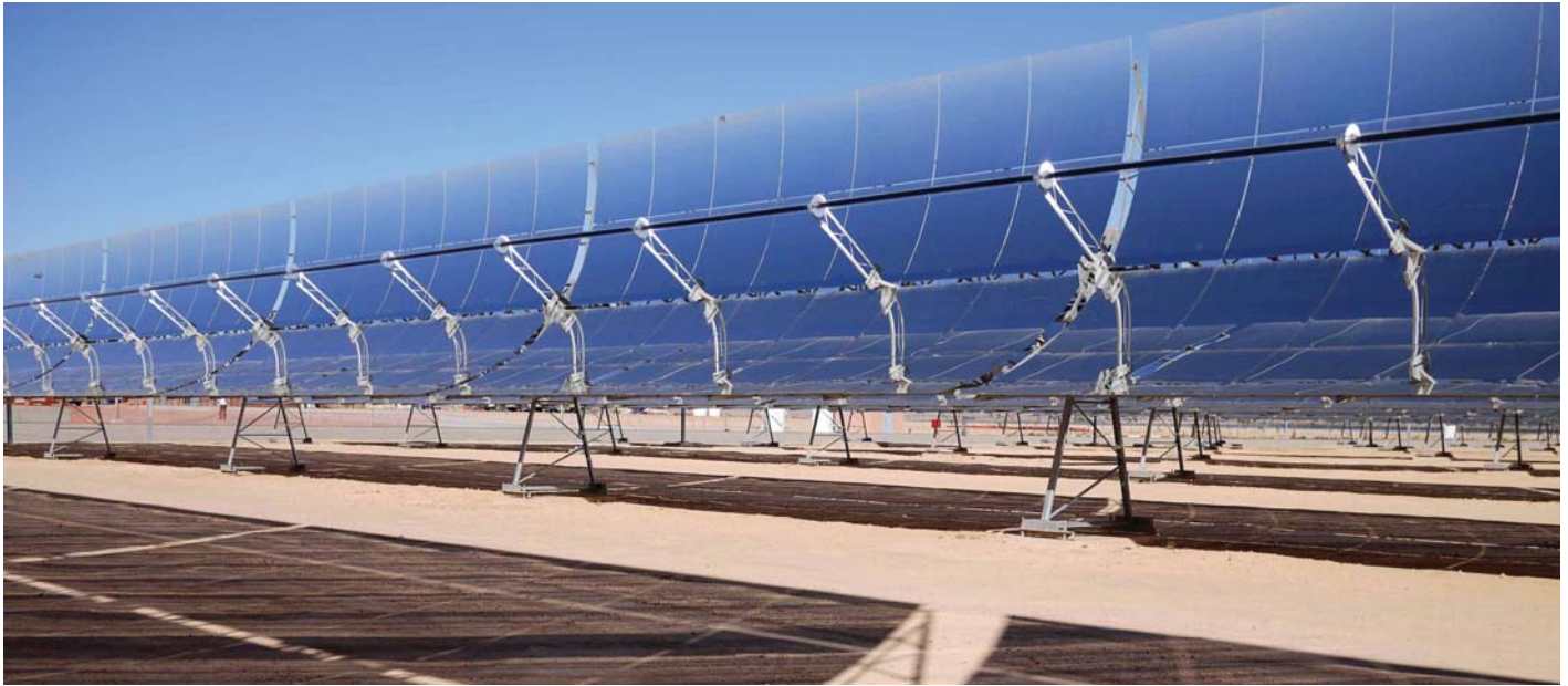
Солнечная электростанция в Айн Бни Матар, Марокко.
