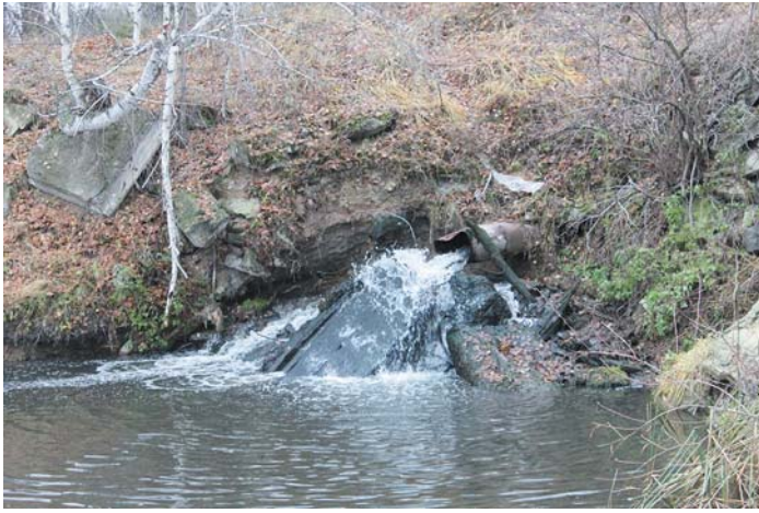
Сброс ливневых вод в реку Мелекесс (приток Черемшанского залива Куйбышевского водохранилища) в черте города Дмитровграда, Ульяновская область.
