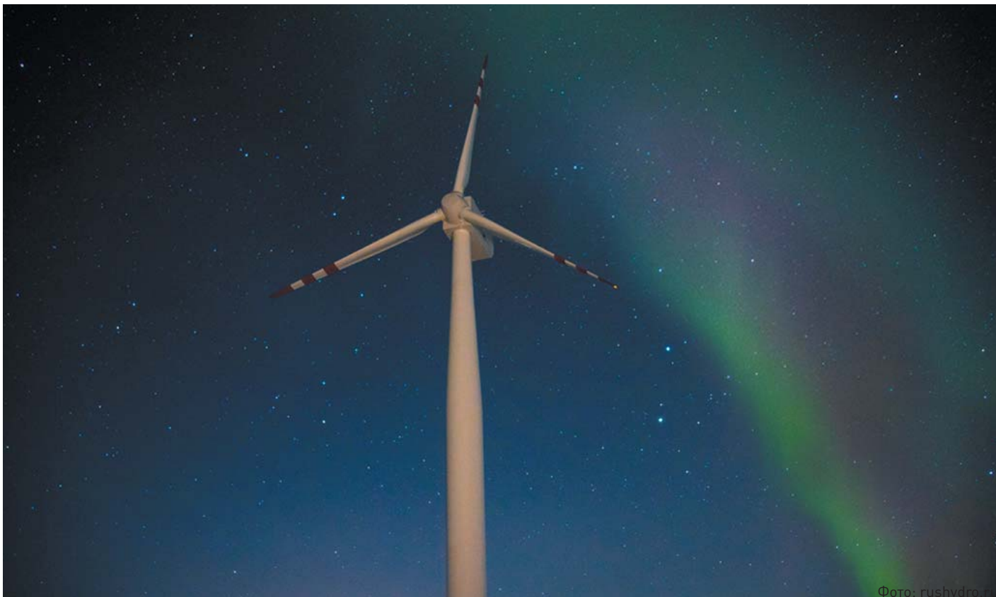
Ветроэлектростанция в Тикси, Якутия.
