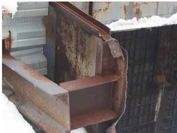
Причины обрушения – некачественный монтаж, отступление от проекта, прогнившие плиты, протечки осадков... Фото: www.chnpp.gov.ua
