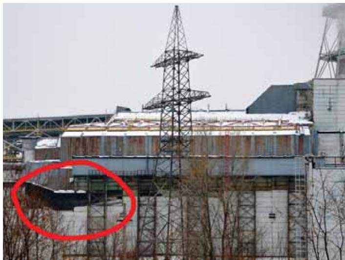
Обрушение конструкций машзала 4-го энергоблока Чернобыльской АЭС 12 февраля 2013 года. В правом верхнем углу – знаменитая вентиляционная труба аварийного энергоблока. Фото: www.chnpp.gov.ua
